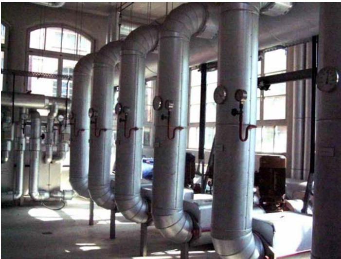
Netz-Umwälzpumpenanlage vor Umbau
