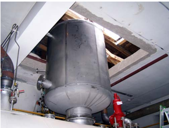
Edelstahl-Rieselentgaser 40m 3 /h auf bestehendem Speisewasserbehälter
