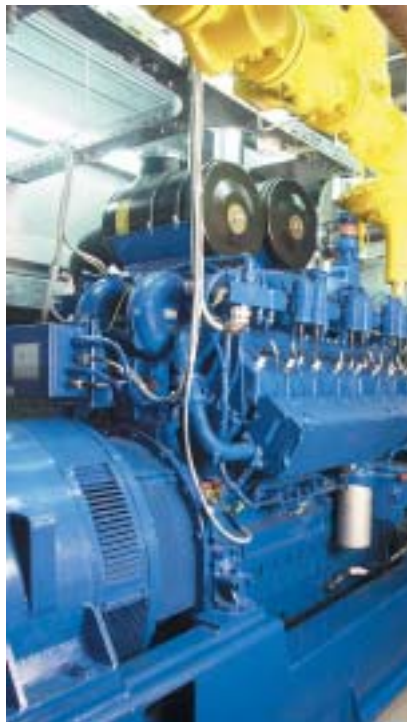
Effektive Energieversorgung im Kreiskrankenhaus Sigmaringen: Ein 720 kW-BHKW von Menag Energie mit einem 16-Zylinder-Gasmotor von Deutz, gepuffert durch einen 30 000 l-Schichtenspeicher (Fotos: Midiplan)
