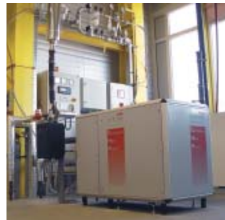
Kompakte BHKW-Anlagen: Der Stirling-Motor von Solo ist schon in Clausthal im Einsatz (Bild: Solo)
